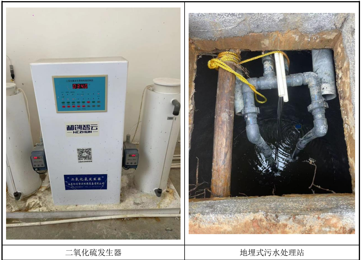
图 4.2-2 项目废水治理设施图
