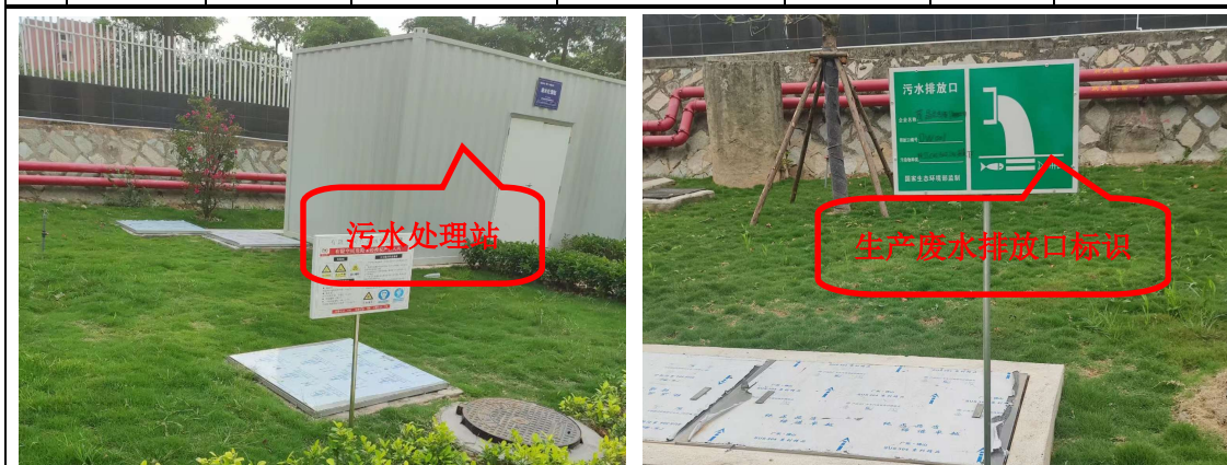
图 3-1 生产废水治理措施现场照片
