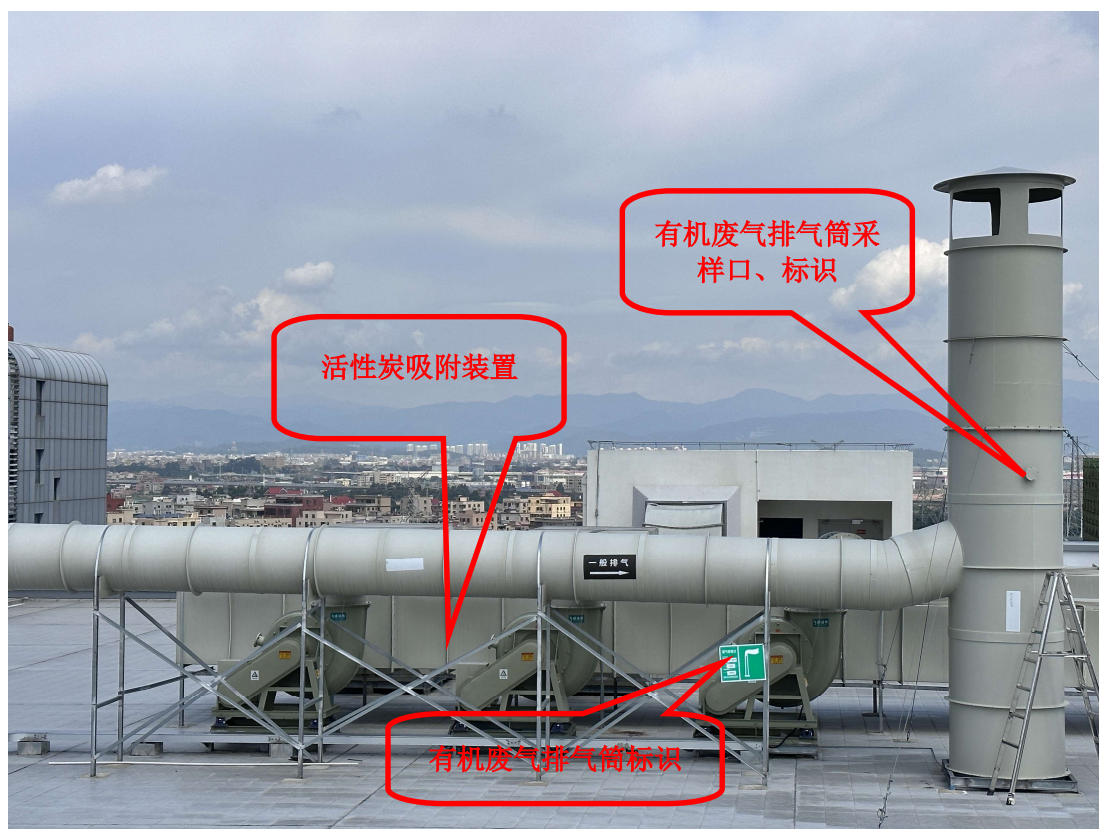
图 3-2 废气治理措施现场照片
