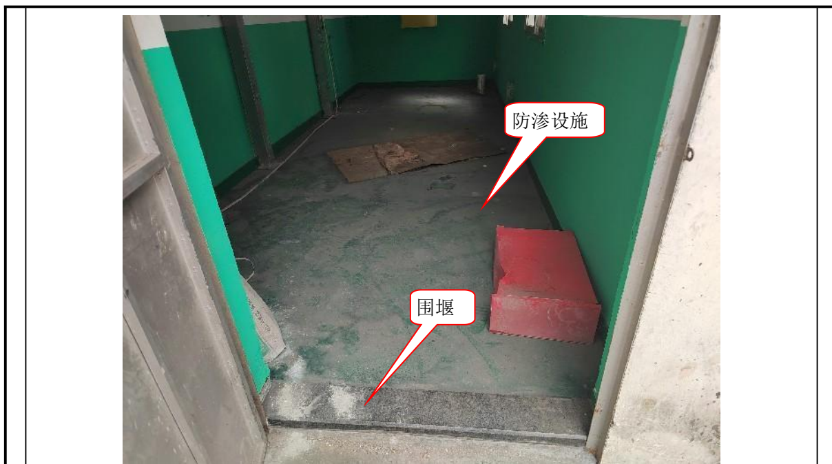
图片 3 机油仓库风险防范设施
