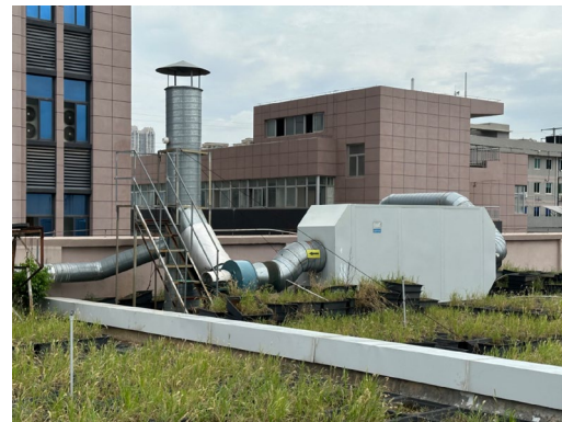
过滤棉+活性炭处理设施、排气筒 (FQ-202218-1)
