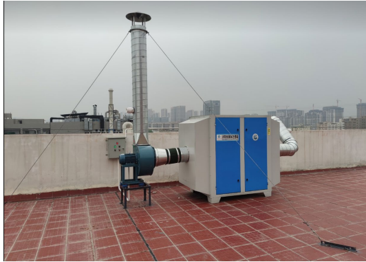
活性炭处理设施、排气筒 (FQ-202218-2)
