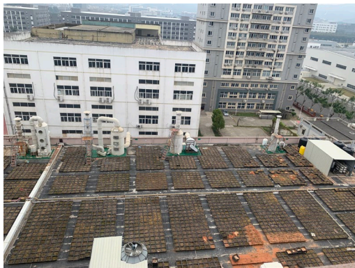
2#楼排气筒、废气处理设施
