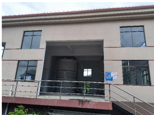
接触消毒池及加药间
