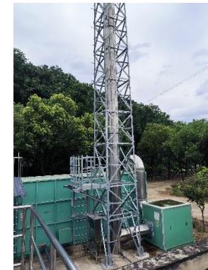
臭气处理装置
