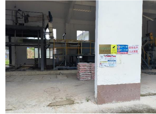
污泥脱水车间
