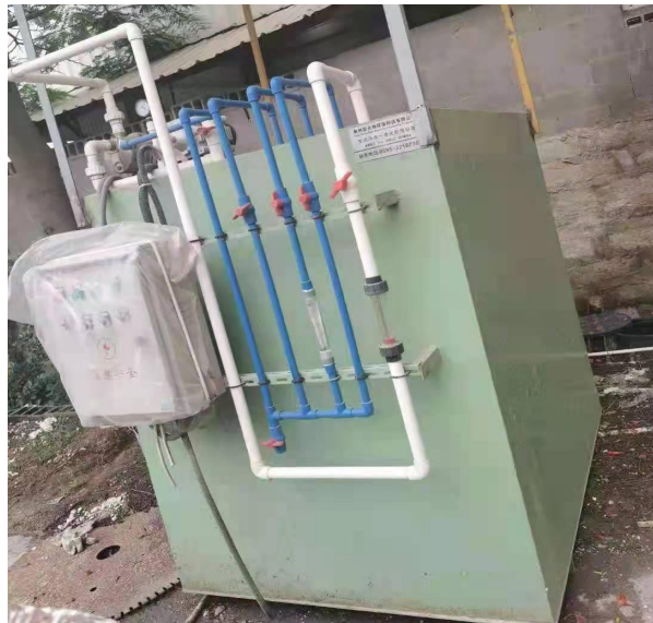
图 4-4 生活污水处理设施
