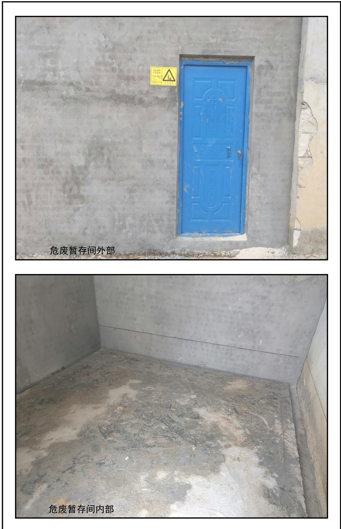
图 4.1-7 项目危废暂存间现场拍摄图
