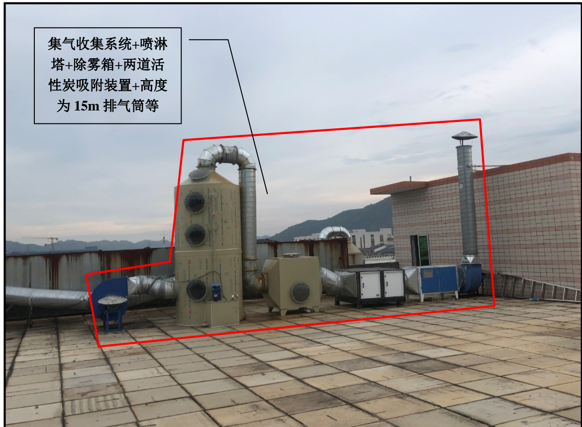
图 4.1-4 项目废气治理设施现场拍摄图
