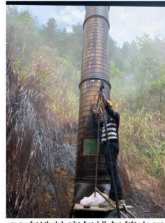
P2有造粒废气排气筒出口
