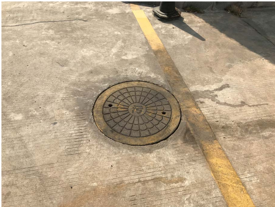
图 4.1 生活污水收集情况图
