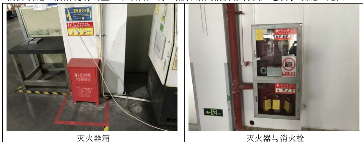
图4.4 消防器材及应急防护设施配备情况
