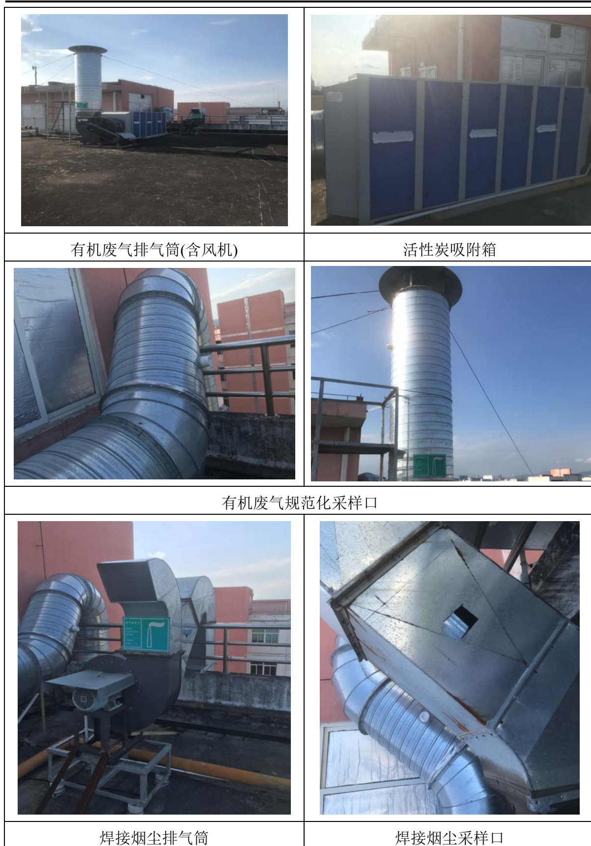
图4.2 废气收集及处理设施情况现场调查照片
