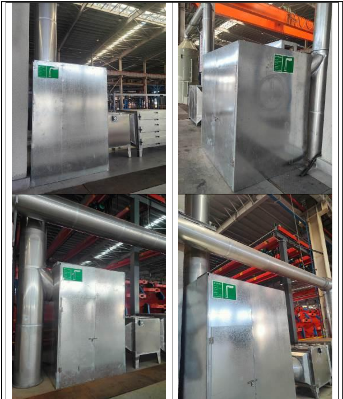
废气处理设施
