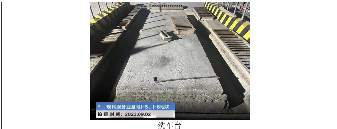
图 4-1 运输车辆设置的清洗设施情况现场图
