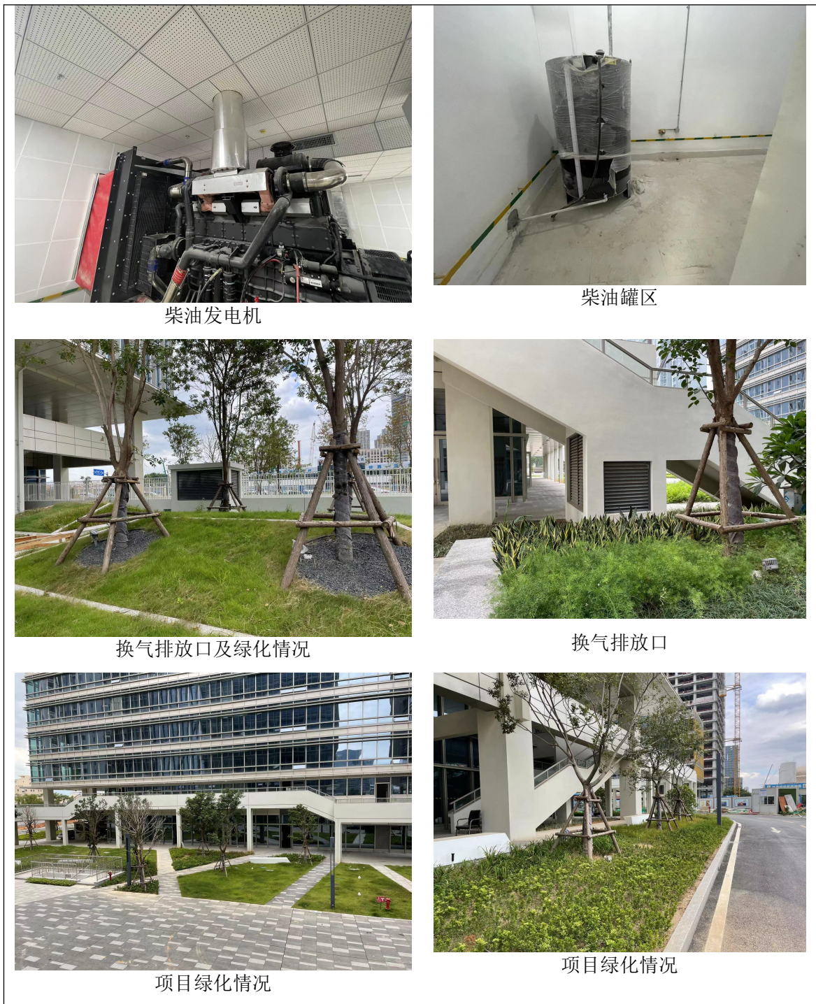
图 4-4 废气设施设置情况现场图
