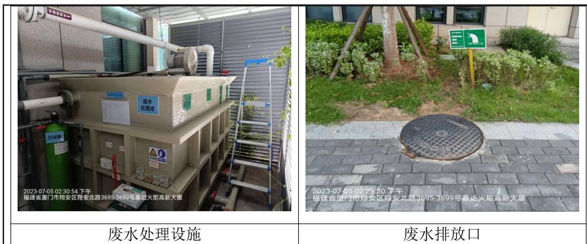
图 3.1-2 项目废水治理设施
