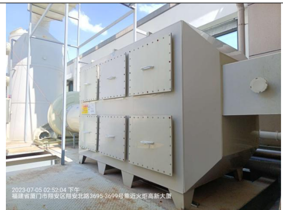
4楼废气处理设施
