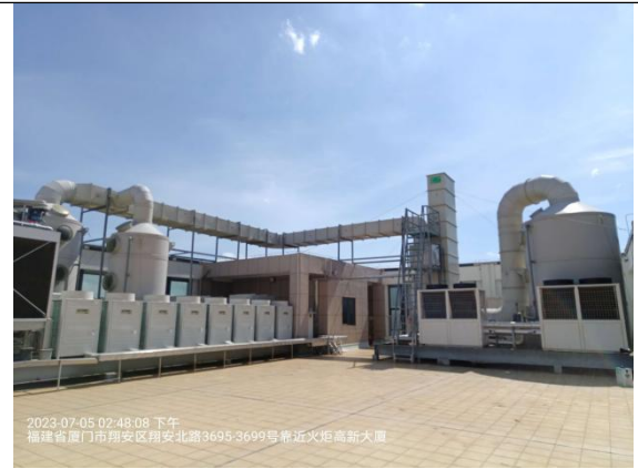
3/4/5层实验室废气处理后合并 35m 排气筒排放
