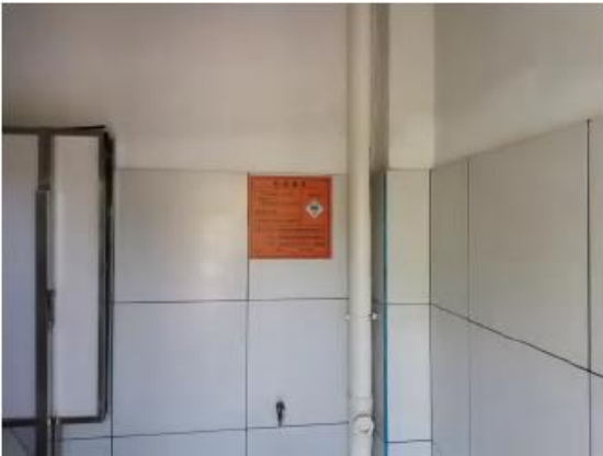
危险废物贮存库
