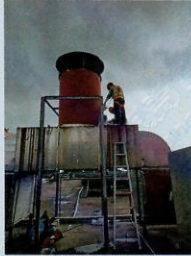
Z5 厂房喷涂废气 1 处理设施出口 (◎5)
