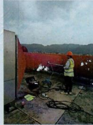
Z5 厂房喷涂废气 2 处理设施进口 1 (◎6)
