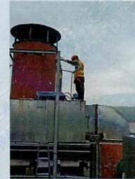
Z5 厂房喷涂废气 2 处理设施出口 (◎8)
