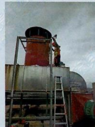
Z5 厂房喷涂废气 3 处理设施出口 (◎11)
