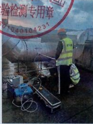
Z4 厂房冷板喷涂废气处理设施进口 (◎1)
