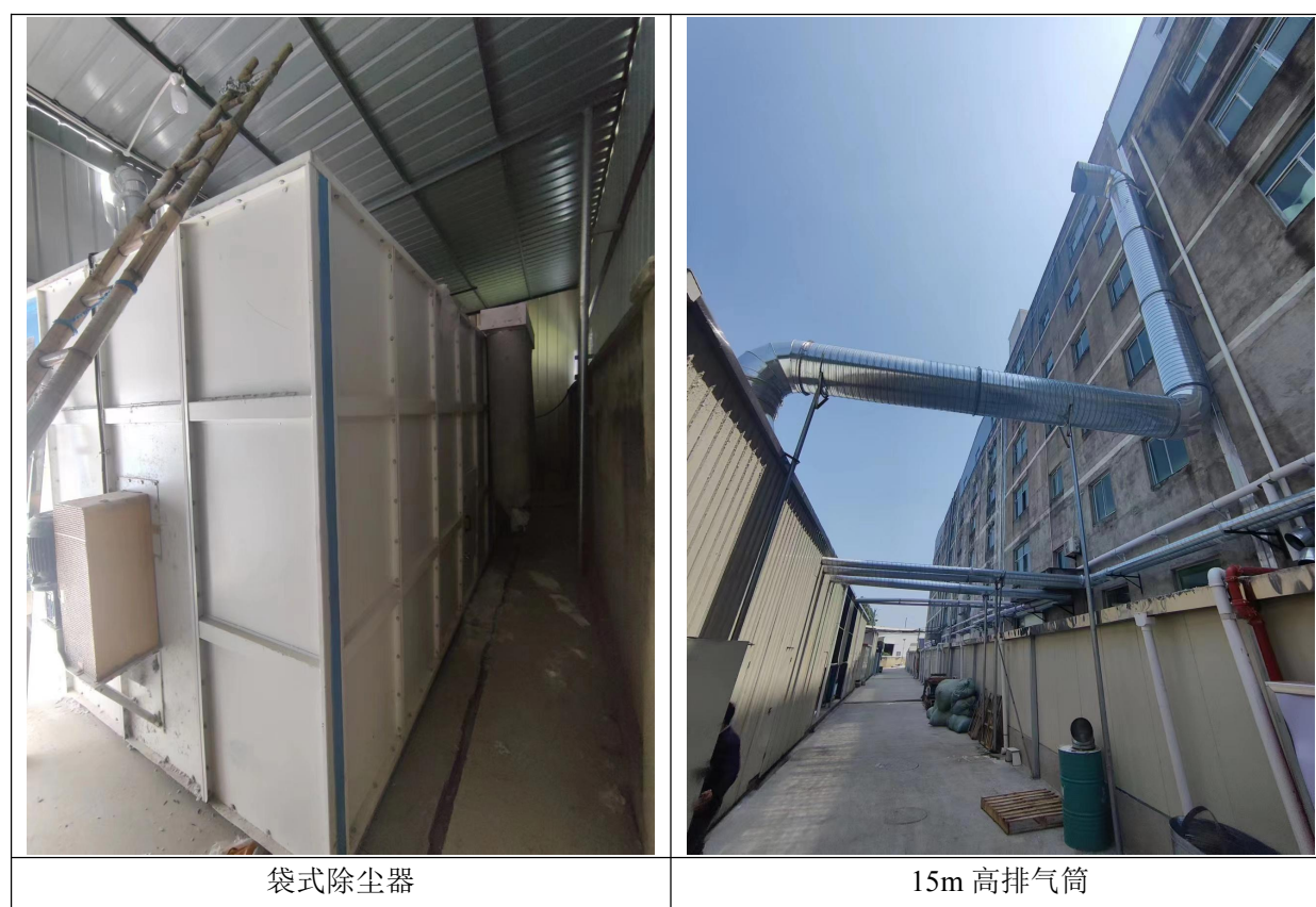
图 4-4 项目废气处理设施图
