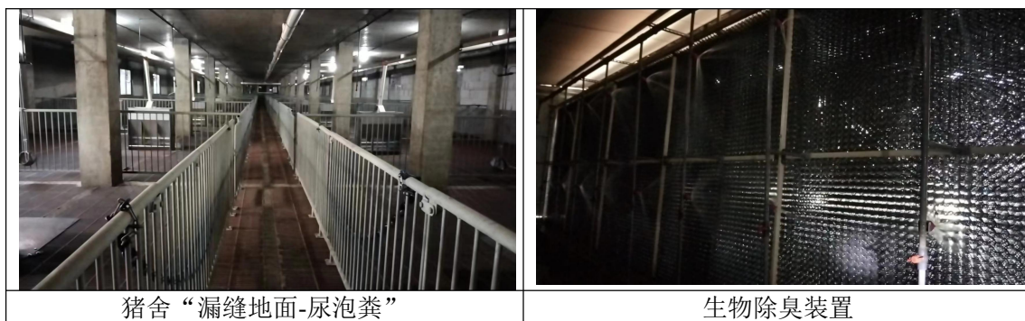
图4.2-1废气治理设施现状图
