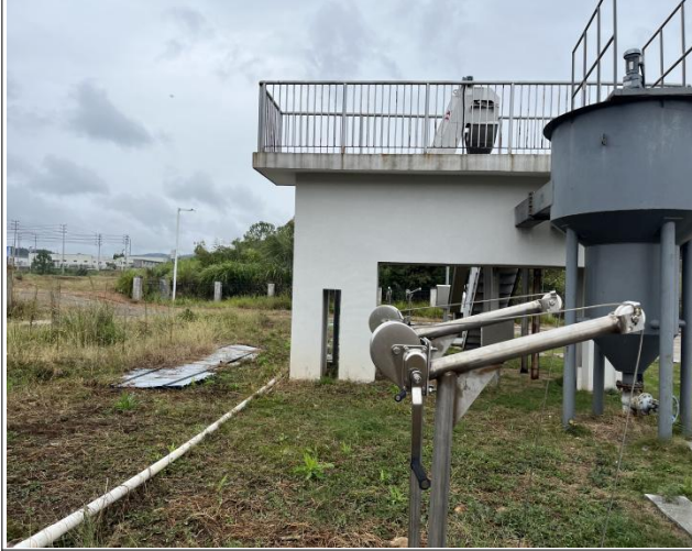
进水泵房及粗格栅
