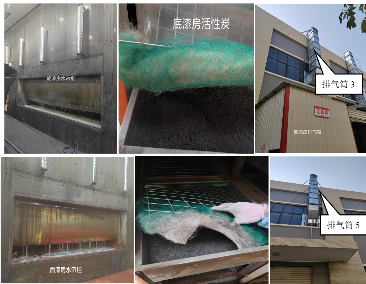
图 4-7 喷漆废气处理设施照片
