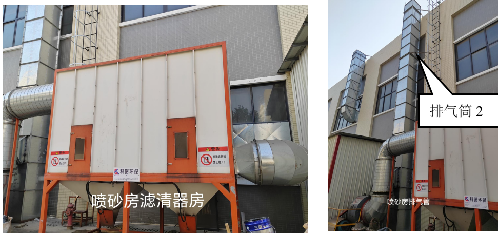
图 4-5 喷砂粉尘处理设施照片
