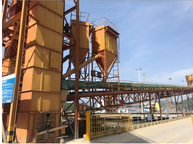
密闭空气斜槽及布袋除尘器
