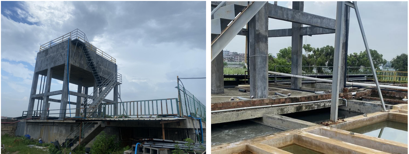
图 4-2 清洗废水处理设施图片
