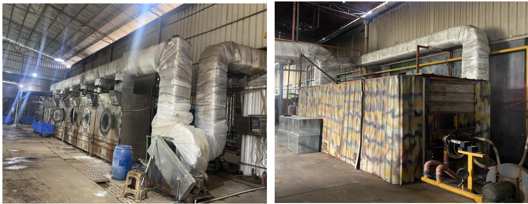
图 4-5 热气回收系统图片
