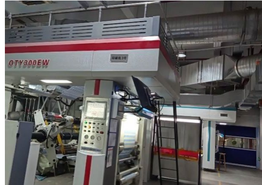
废气收集管道
