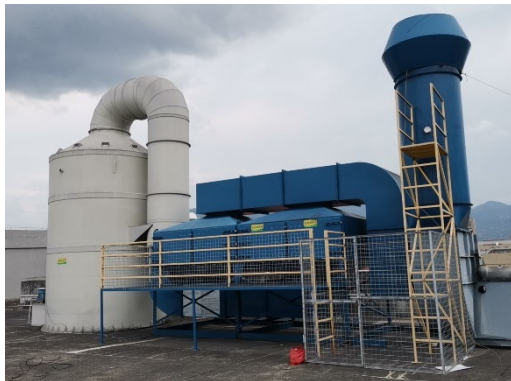
有机废气处理设施
