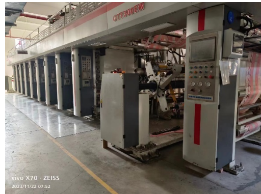
废气集气管道
