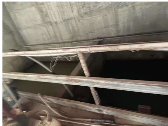
喷雾系统水池
