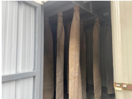
布袋除尘设施
