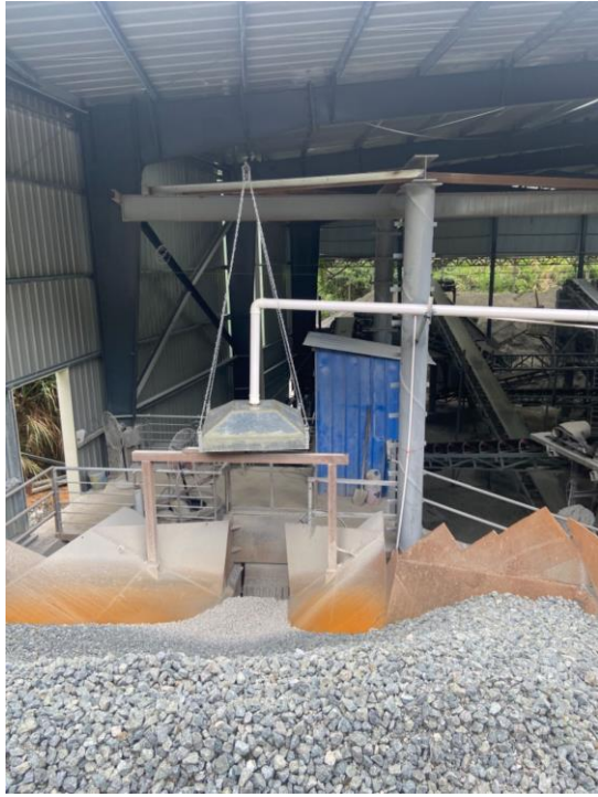
破碎工序废气收集集气罩
