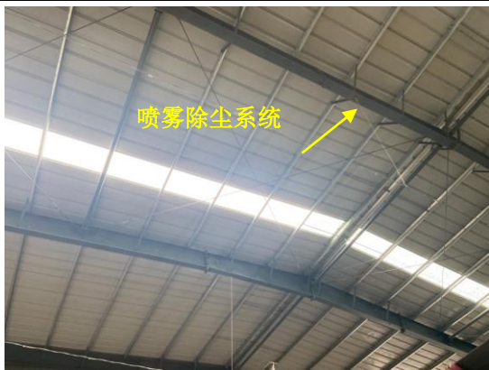
喷雾除尘系统
