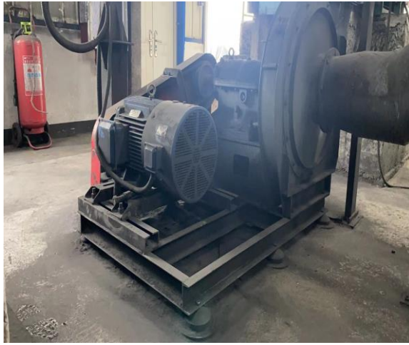
风机减震措施
