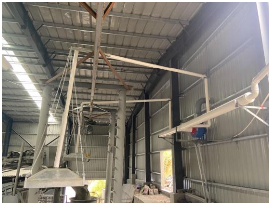
废气收集管道
