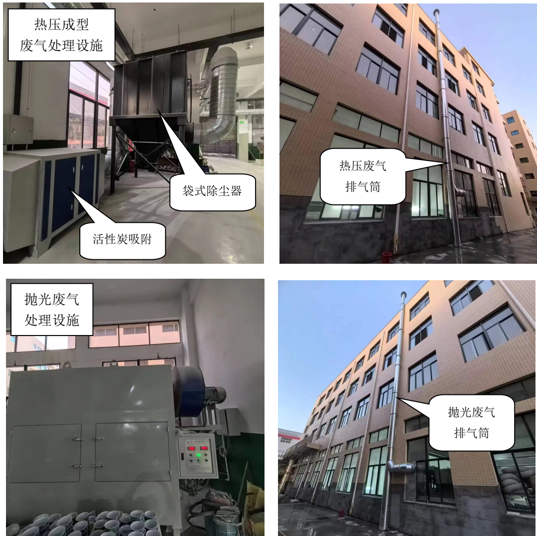
图 4-4 废气处理设施图
