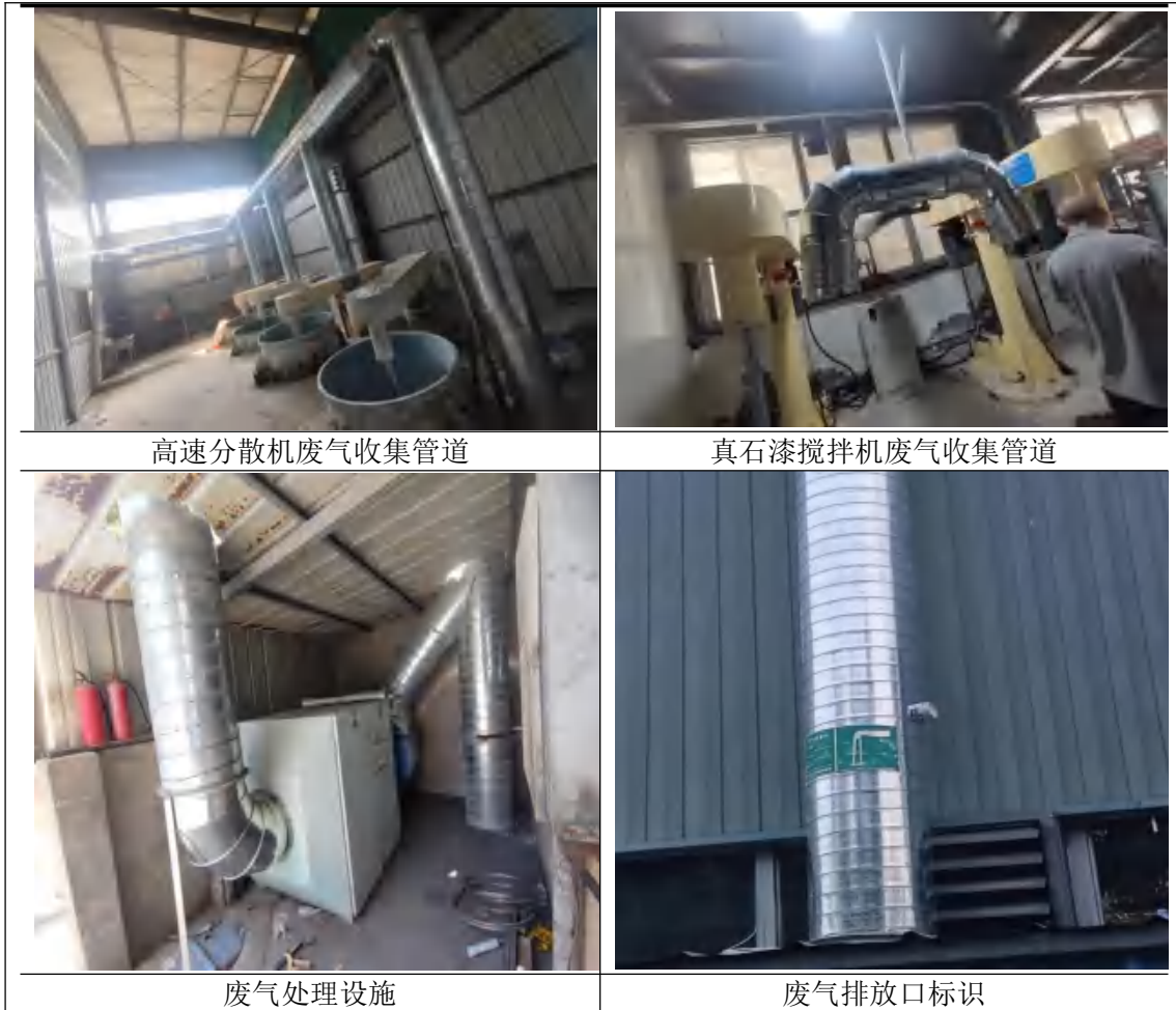
图3.2-3 相关废气处理设施照片
