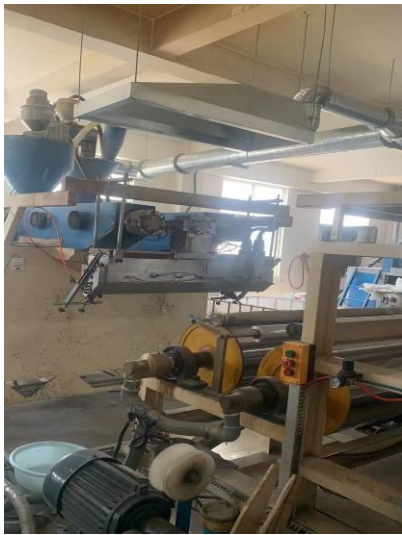
废气排气管道
