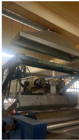
废气排气管道
