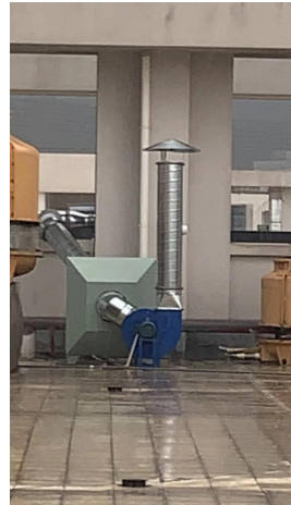
废气处理设施
