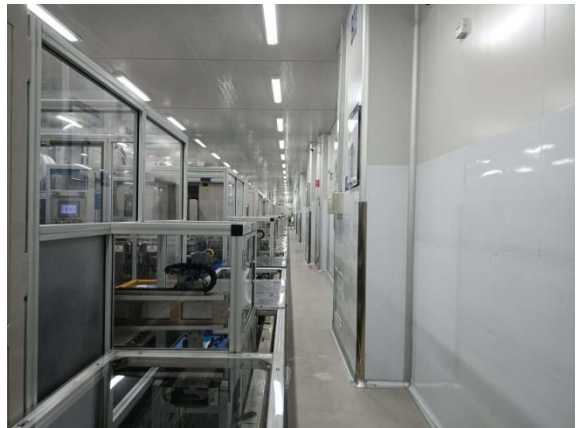
CT 机楼上卷绕拉线区（车间外）
