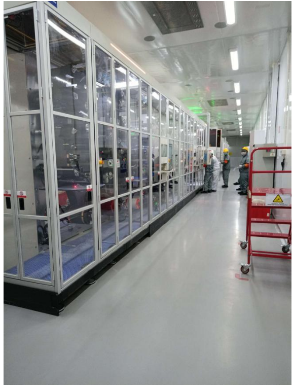
CT 机南侧叠片拉线区（车间外）
