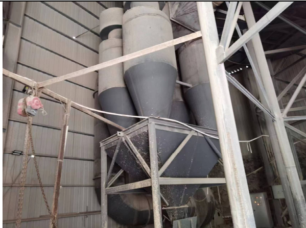
本项目现状-干燥废气旋风除尘装置
