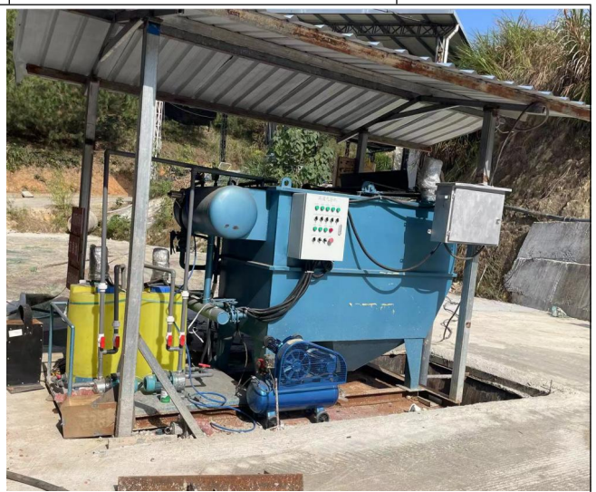
污水处理设备（隔油+絮凝沉淀+回用池）
