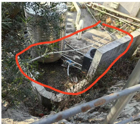
图 5.2-1 福州福融泽实业有限公司机制砂项目化粪池
