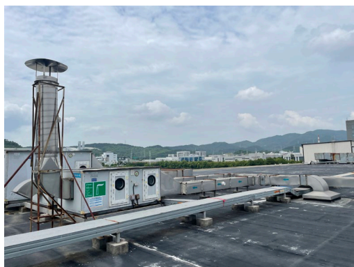
排气筒+活性炭吸附装置
