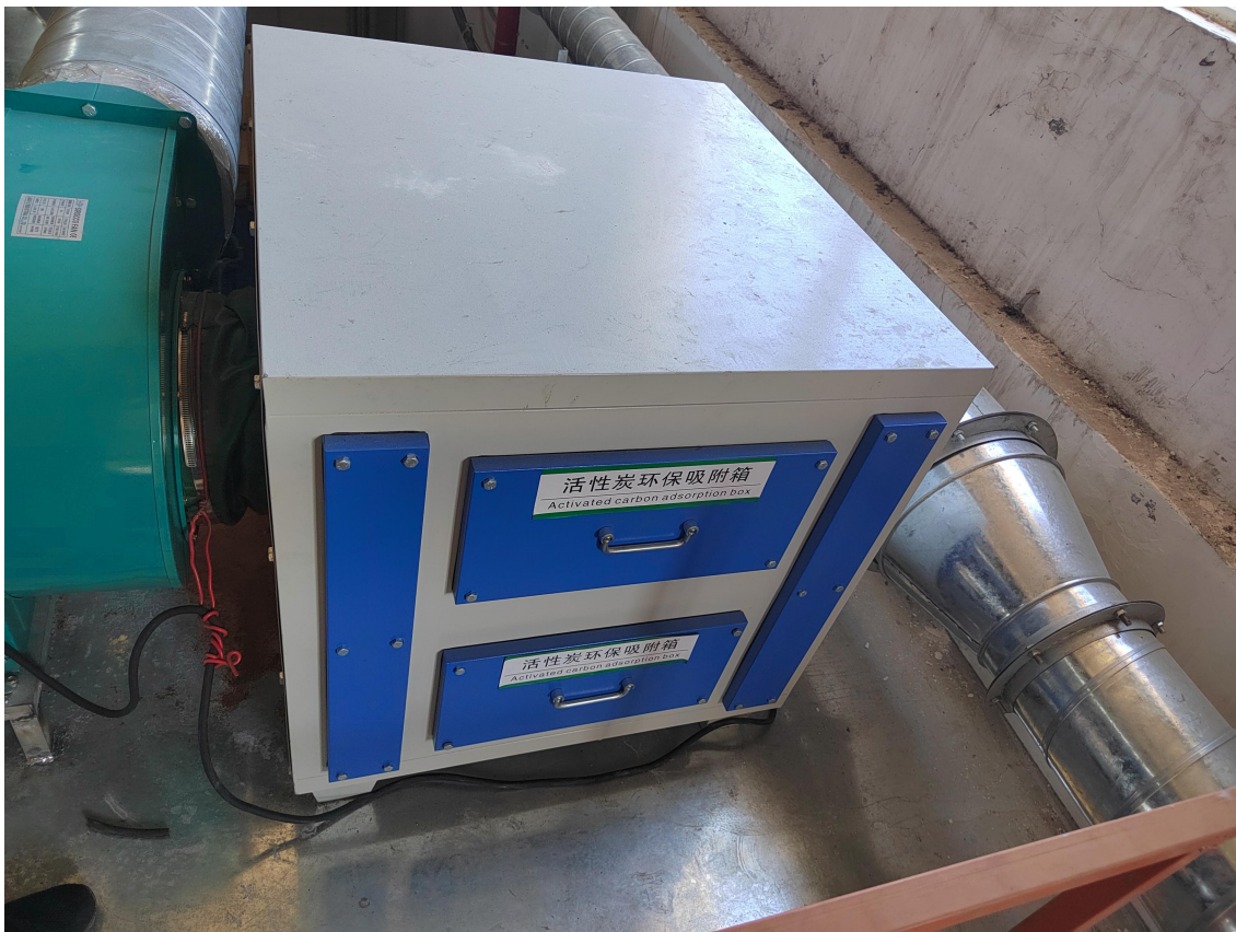
图片 2 吹塑废气活性炭处理设施
