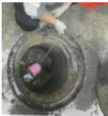
生活污水排放口
