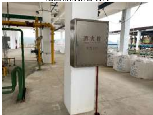
生产车间消防栓
