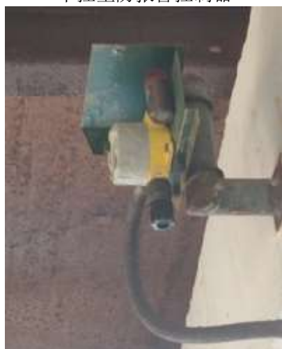
铝溶胶生产车间氢气检测报警装置 1
