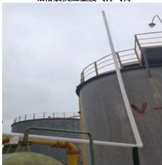
液体罐区废气排气筒
