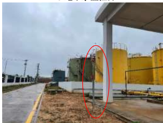
泵棚消防报警装置
