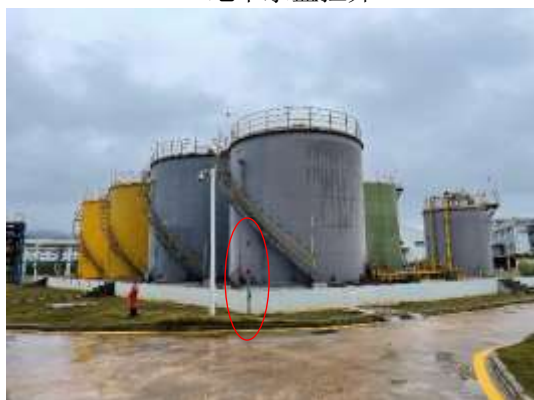
罐区消防报警装置
