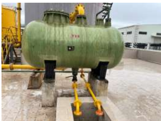
液体罐区碱液吸收罐
