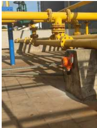
液体罐区氯化氢气体报警检测装置
