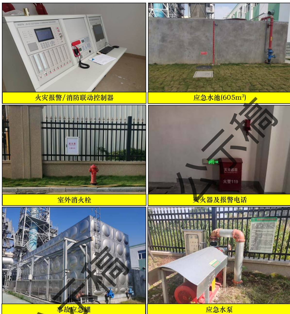
图4.7 消防设施配备现场照片
