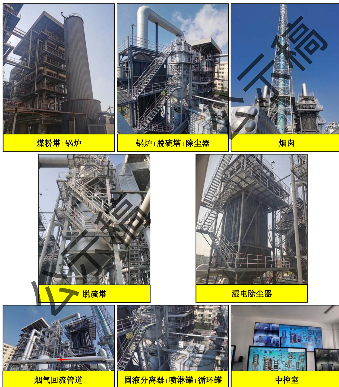
图4.1 锅炉烟气污染防治措施现状照片
