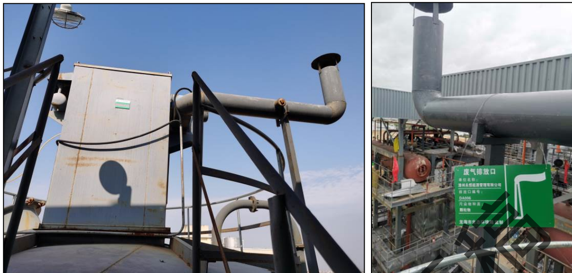
图4.2 煤粉塔废气处理设施现状照片
