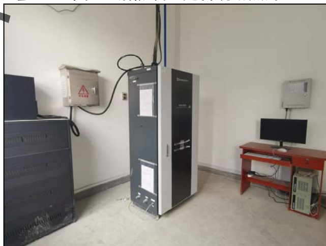
图4.8 在线监测设备现场照片
