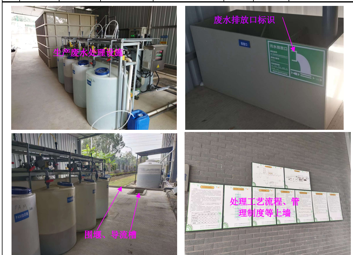
图 3-1 生产废水治理措施现场照片
