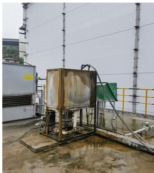
设备冷却水循环系统 2
