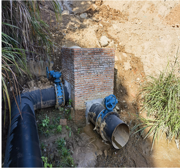
两个初期雨水沉淀池的阀门
