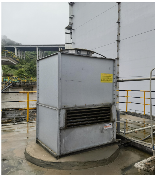
设备冷却水循环系统 1
