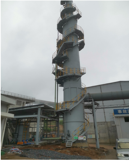
石灰窑煅烧烟气排气筒（35m）
