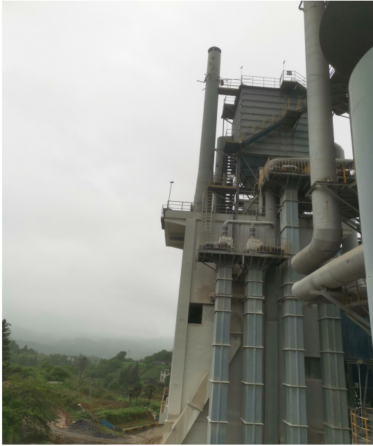
石灰成品储运系统废气 1#排气筒（15m）
