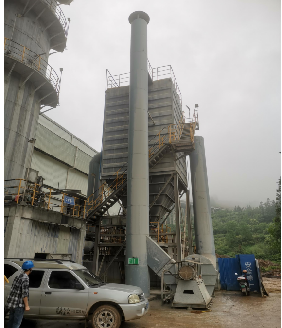
石灰成品储运系统废气 2#排气筒（17m）
