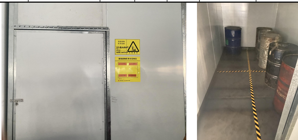
图 4-3 危险废物暂存间
