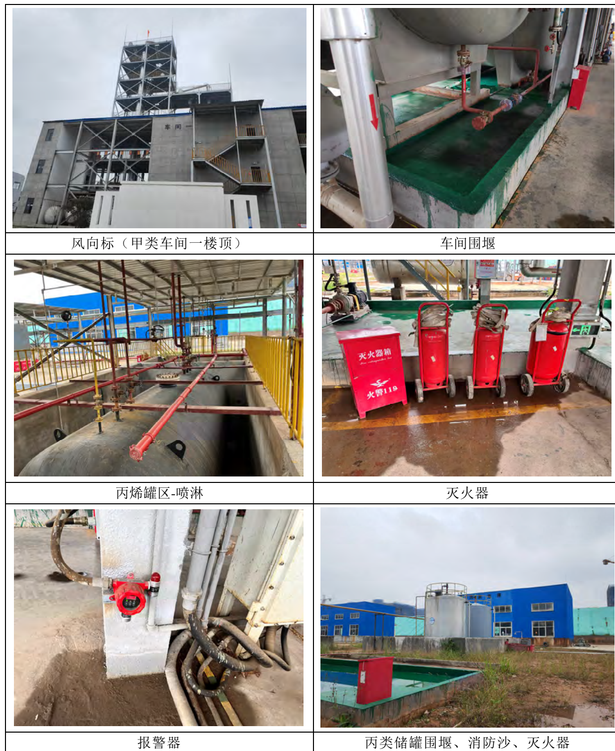
图 2.4-6 应急措施及物资现场照片
