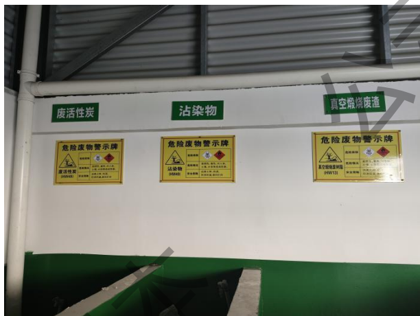
危险废物贮存间（分类暂存，地面、墙体防渗设施）
