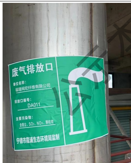
天然气锅炉排放口, 备用 (DA011)
