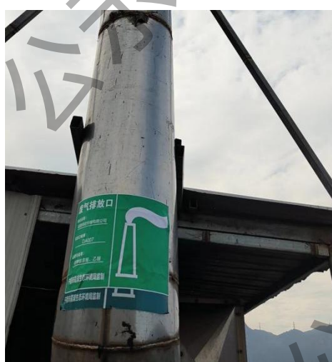
前纺、后纺废气排放口标志牌 (DA007)
