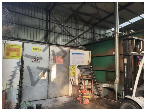
废气处理设施（微负压收集+活性炭吸附装置）
