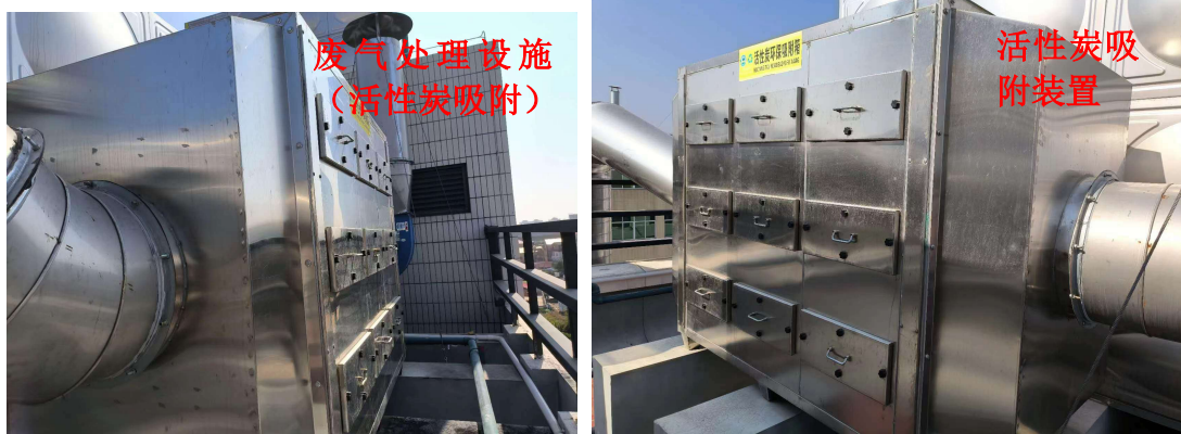
图 3-2 废气污染防治措施照片
