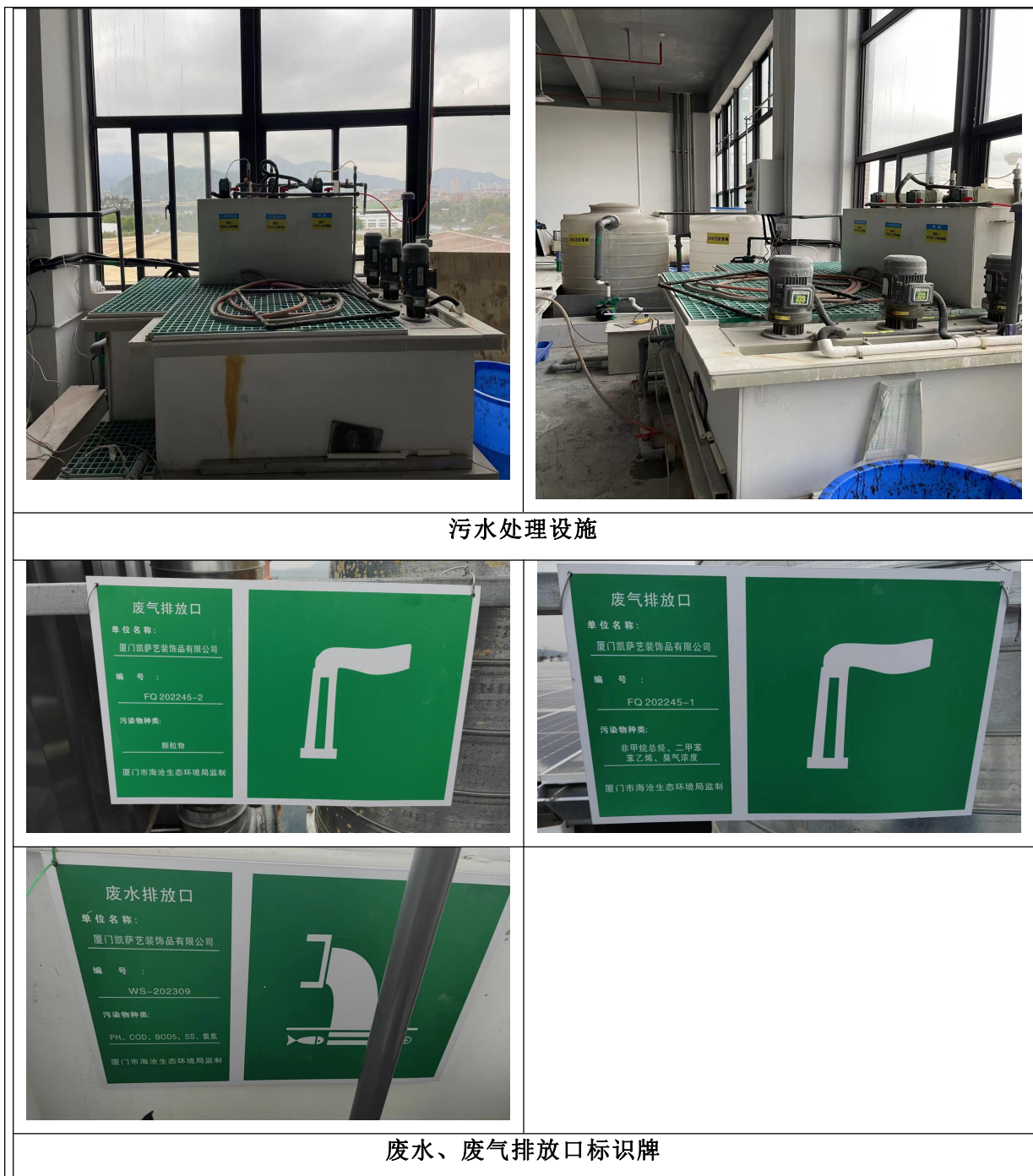
图 3-1 项目废水、废气处理设施现场图
