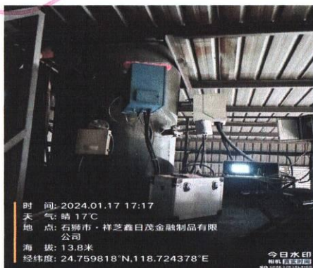
排气筒废气总排出口 (Q1 出口)
