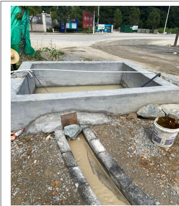
排气沟末端连接一座入口处的初期雨水沉淀池（容积 10m 3 ）
