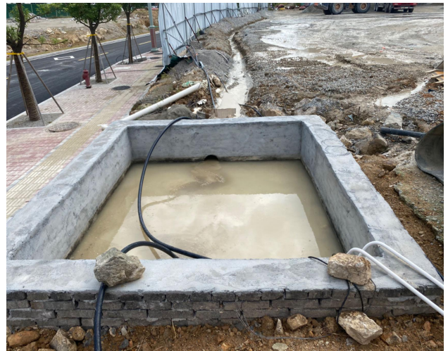
厂区东侧一座初期雨水沉淀池（容积 12m 3 ）
