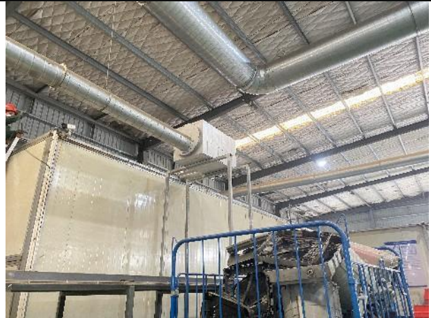
液晶拆解工位废气处理设施：活性炭过滤系统
