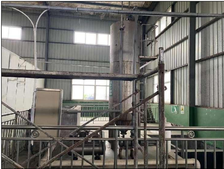
厂内污水处理站
