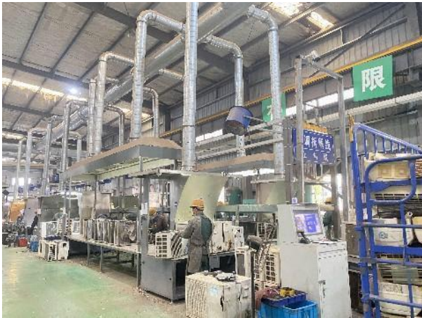
空调拆解线集气罩
