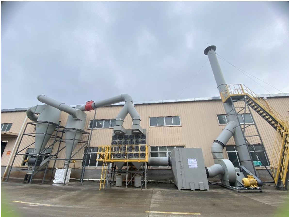
冰箱拆解线废气处理设施：两级旋风+滤筒+活性炭吸附+15米排气筒（DA002）
