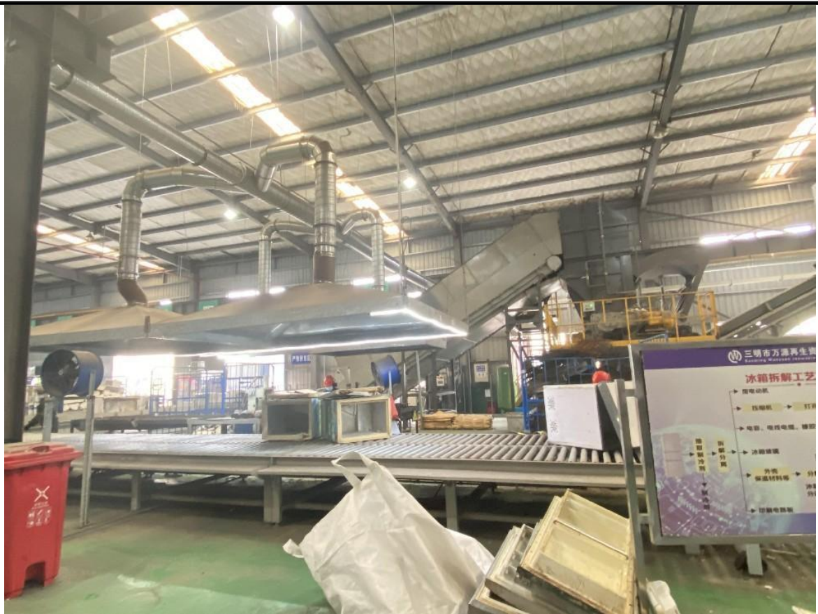
冰箱拆解线集气罩
