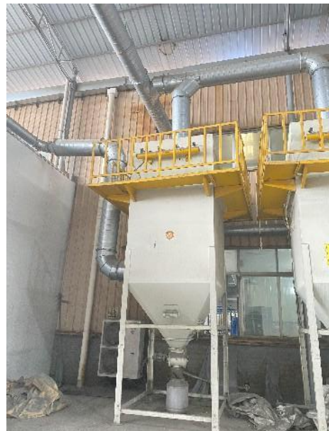
破碎废气处理设施：布袋除尘器
