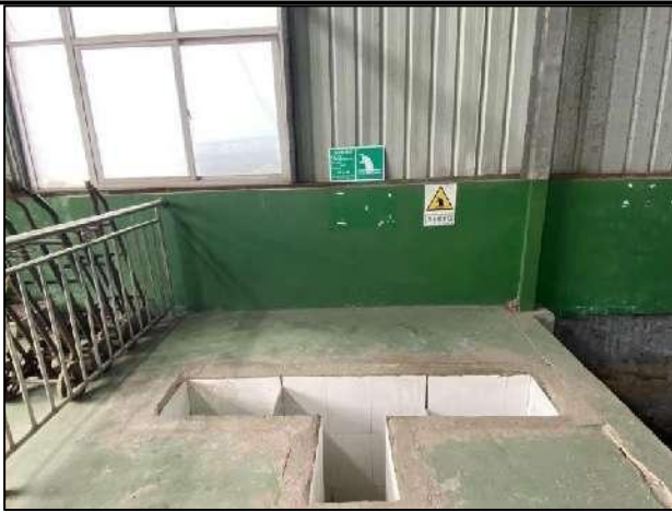
厂内污水处理站废水排放口 DW001
