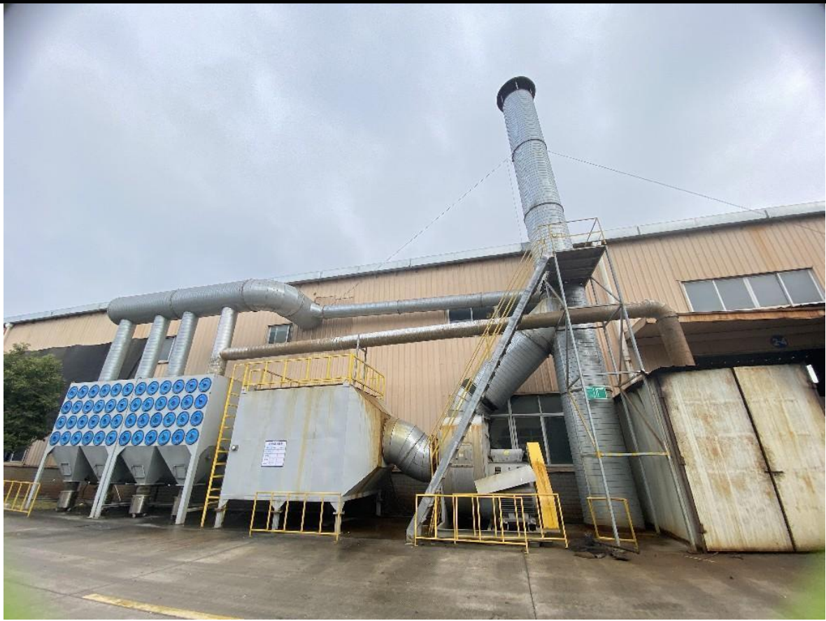
电视电脑液晶、洗衣机、空调拆解线废气处理设施：滤筒+活性炭吸附+15米排气筒（DA001）
