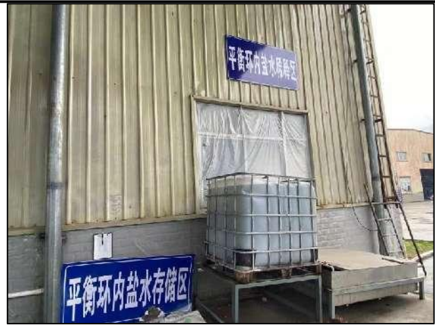
冰箱拆解线平衡盐水存储区及稀释区
