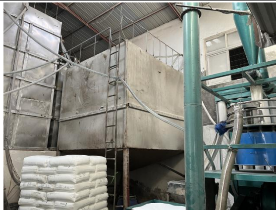
磨料间布袋除尘器
