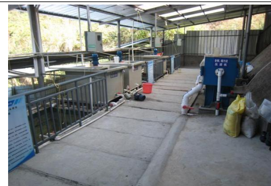
废水处理系统 1
