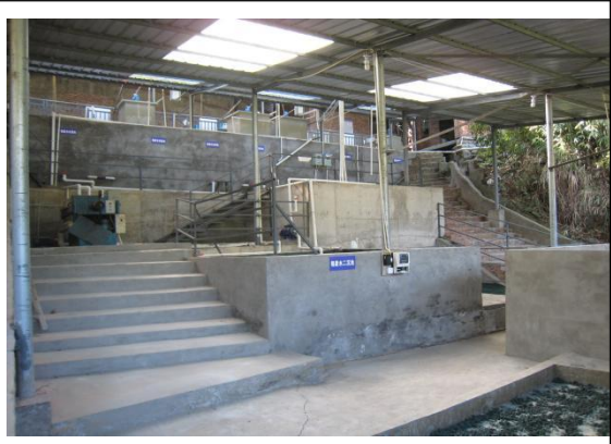
废水处理系统 3
