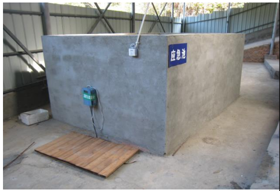
应急池(原污水综合处理池)
