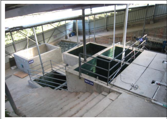
废水处理系统 2
