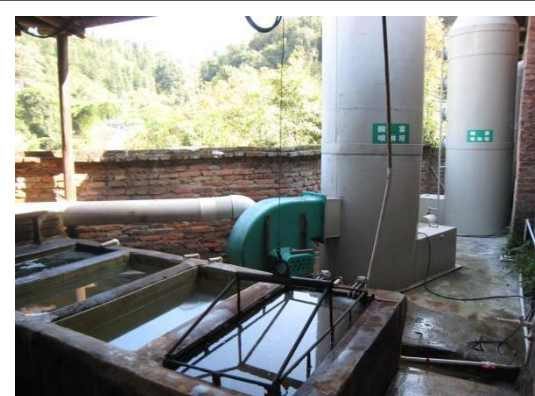
酸雾碱雾吸收塔
