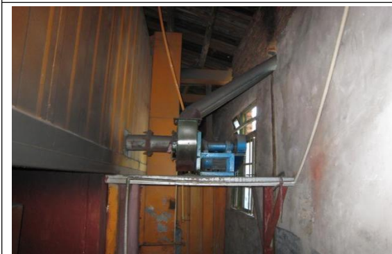
锅炉废气排放口
