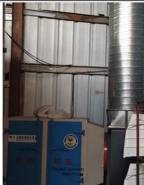
喷漆废气处理设施
